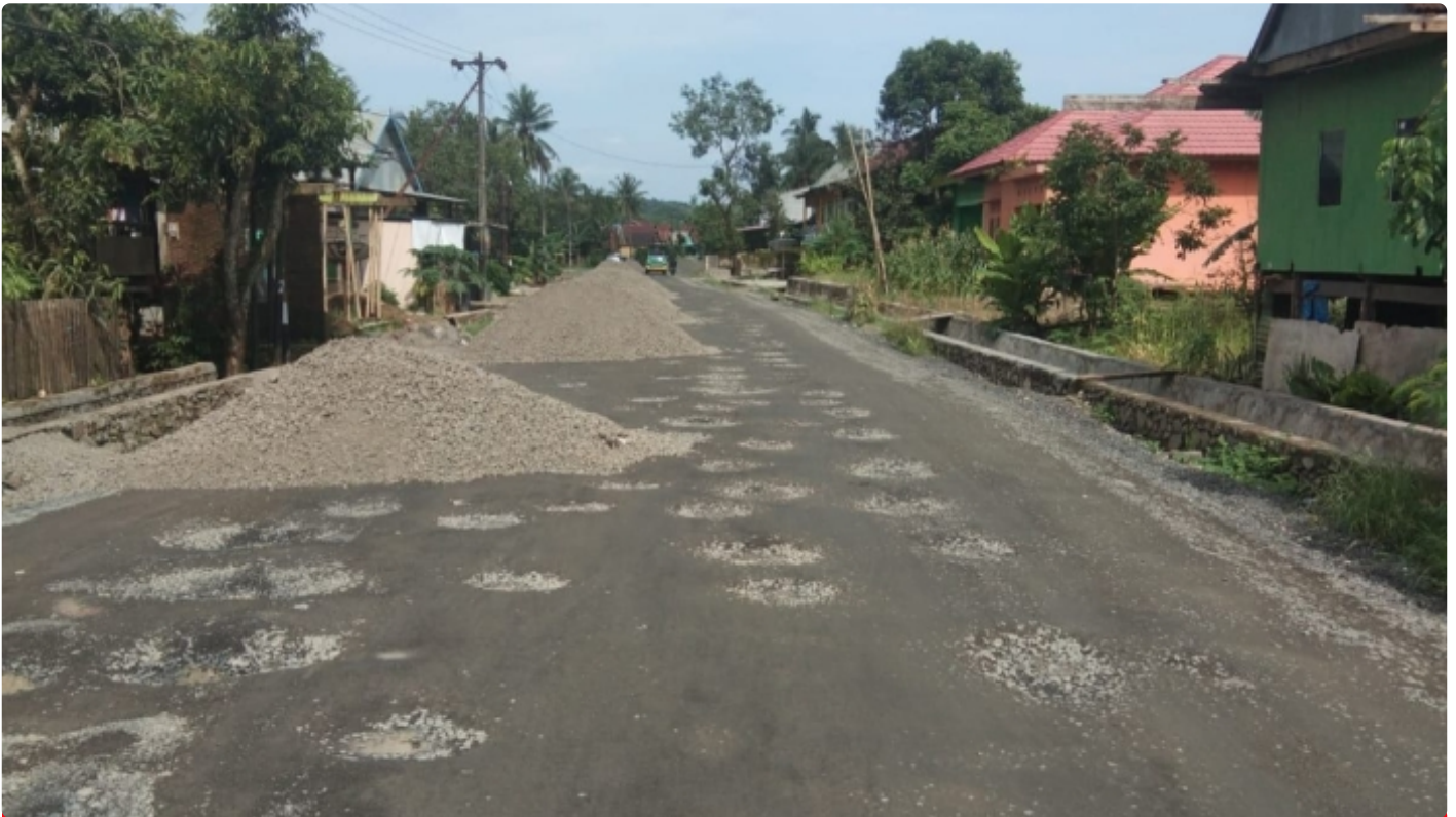
Kondisi jalan Poros Pekkae-Takkalalla, tepatnya di Ele, desa Lompo Tengah, kecamatan Tanete Riaja, kabupaten Barru
